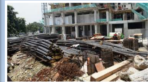
Jatuhnya besi, proyek Rusun Pasar Rumput, Jakarta, Minggu (18/03/2018)
