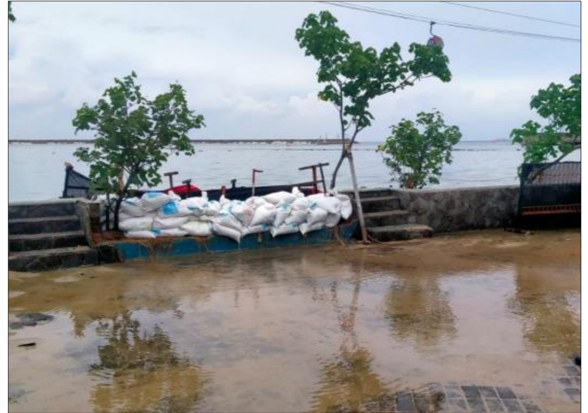
Penanggulangan sementara jebolnya tanggul pantai Ancol, Jakarta Utara, 2021 (PosKota) https://poskota.co.id/2021/12/07/kondisi-terbaru-setelah-tanggul-di-ancol-jebol-kini-tanggul-ditutup-karung-pasir?halaman=1
