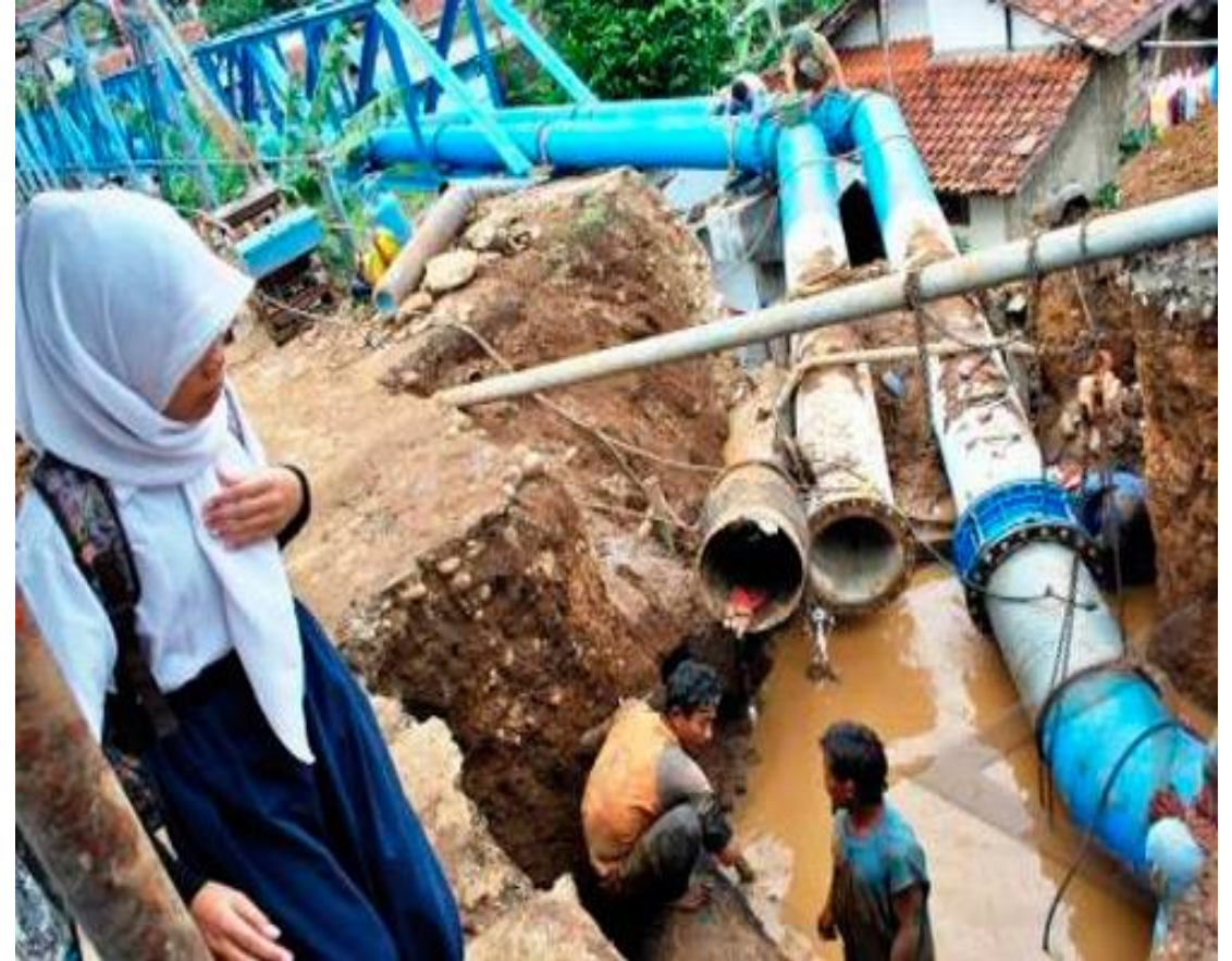
Pipa Air perkotaan rusak, Balikpapan 2014 (Kabar24Bisnis) https://kabar24.bisnis.com/read/20140907/78/255624/pipa-rusak-balikpapan-terancam-didera-krisis-air-bersih
