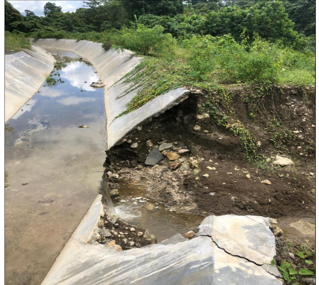
Saluran Irigasi Jebol, Buton Utara, 2021 (SultraKita)
